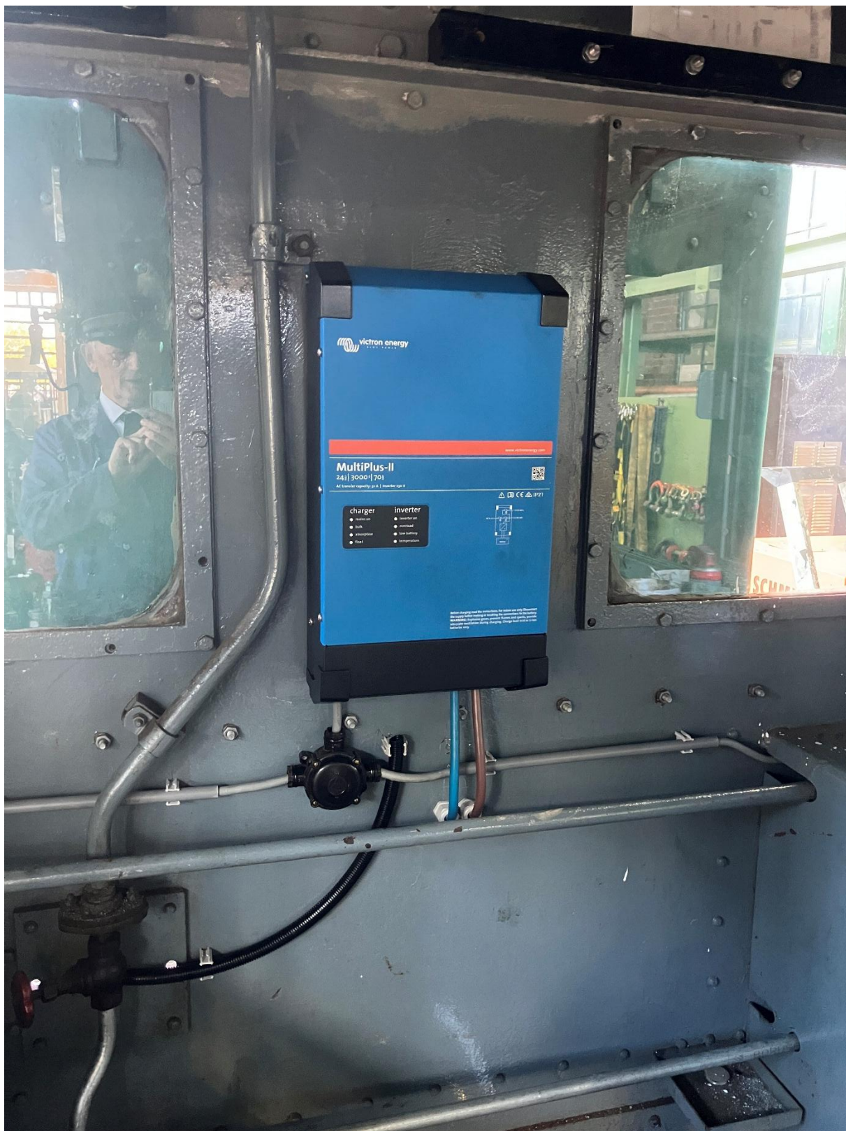
Locomotor NS 271 krijgt niet alleen een luchtreminstallatie voor loc en trein, maar ook een omvormer voor 220V wisselstroom; erg handig voor bijvoorbeeld snoeigereedschap.
