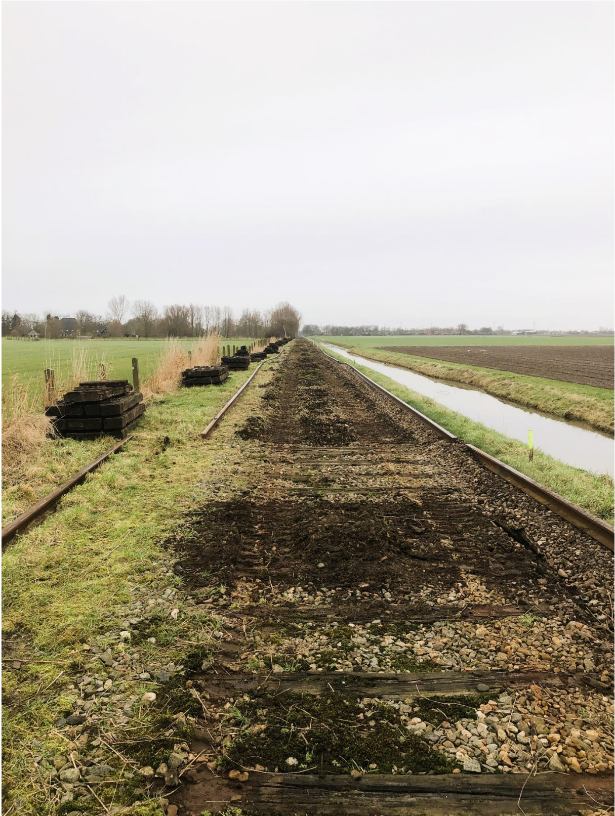
8 februari 2024: overzicht van de spoorvernieuwing, kijkend naar het noorden richting Twisk. Oude dwarsliggers worden verwijderd, en na schonen en vlakken van het ballastbed zullen de nieuwe worden neergelegd.
