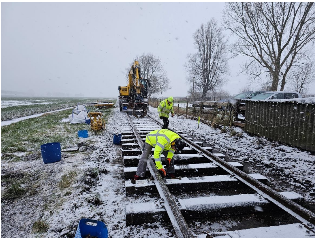
16 januari 2024: ondanks een fikse sneeuwbuï wordt er hard doorgewerkt aan de spoorvernieuwing bij station Benningbroek.
