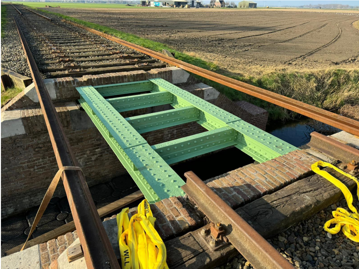
14 maart 2024: de brug over de Zwetsloot ligt weer op z'n plek. Nu de rails nog.
