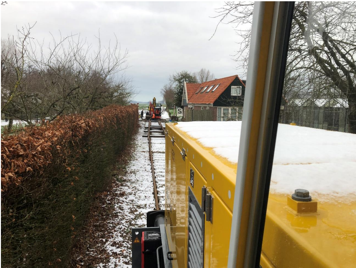
17 januari 2024: ook aan het vernieuwen van de overweg in de Oosterstraat nabij station Benningbroek wordt inmiddels gewerkt.
